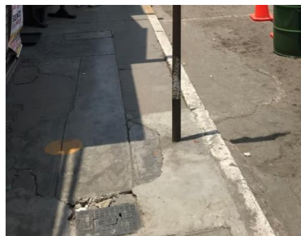
Figura 51: Grietas y obstructor en av. Perú Fuente: Elaboración propia
