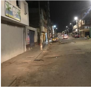
Figura 10: Fallas pavimentos calle Rímac Fuente: Elaboración propia
