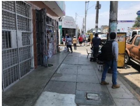
Figura 52. Grietas y desniveles en la vereda de la Av. Perú. Fuente: Elaboración propia.
