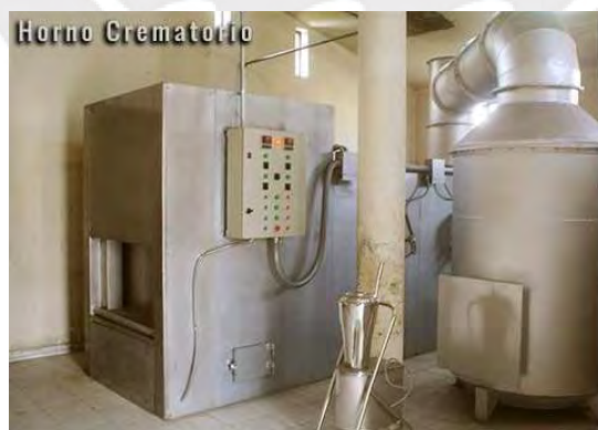
Figura E.3: Vista lateral del horno crematorio de HINSA. Fuente: Hornos HINSA
