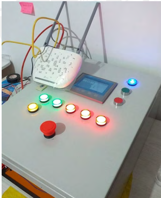
Figura 76. Parte delantera del Tablero Eléctrico del sistema de control de la mini lavadora de fibra de viciña
