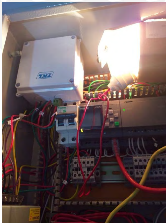
Figura 81. Prueba de variación de potencia aplicada a un foco de 100W
