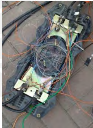
Fig. 2. Caja de transmisión óptica en mal estado
