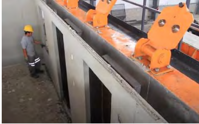
Imagen 78: Desencofrado de estructura – separación encofrado externo
