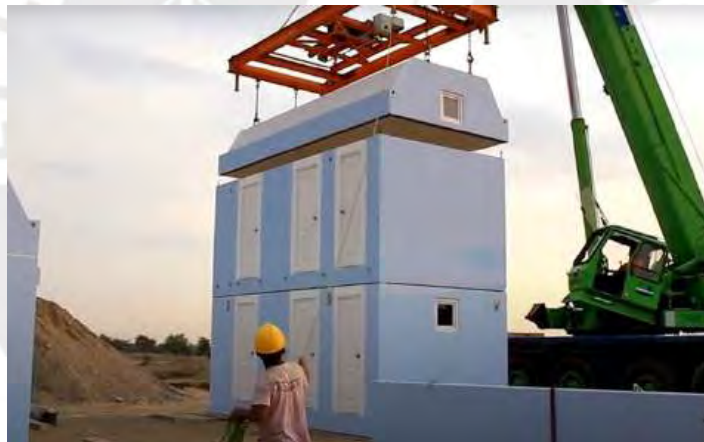
Imagen 86: Ensamblado de módulos en el terreno y entre si Fuente: Reymann Technik & Ratec Org
