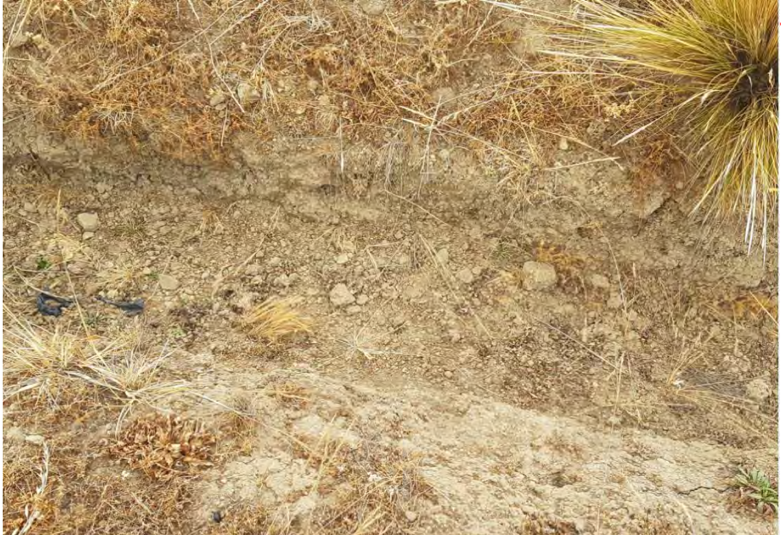
Parte alta de Chaclla, zona de zanjas de infiltración. Profundidad de zanja.
