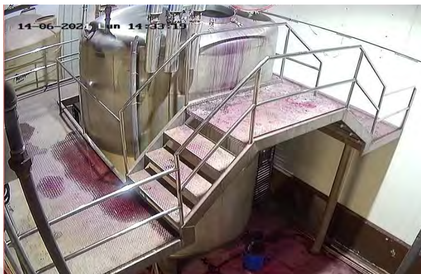
Figura 10. Tanque de Precipitado
