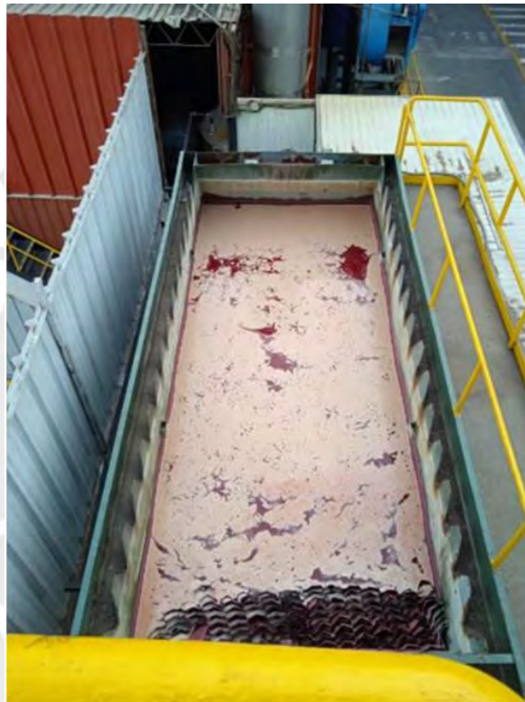
Figura 17. Tanque de Tratamiento de Aguas Residuales
