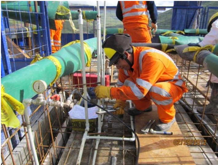
40. Instalaciones sanitarias de losa.
