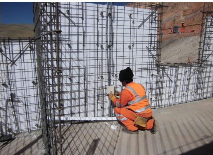
33. Instalaciones eléctricas y sanitarias de muro.
