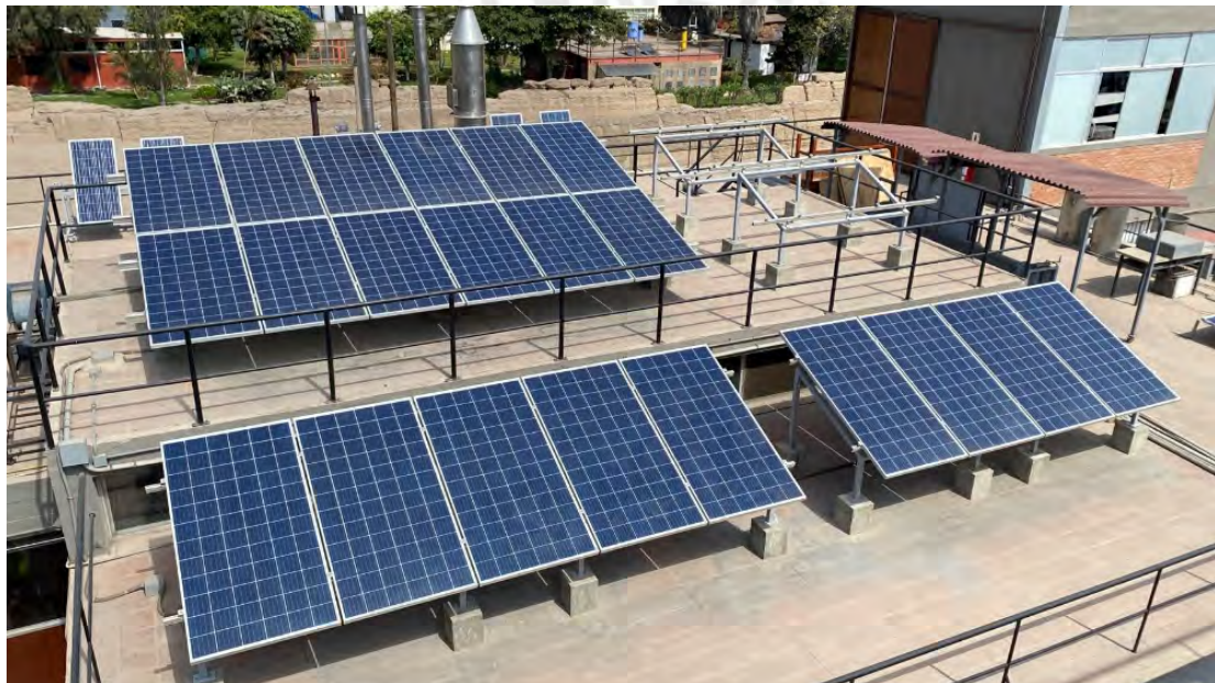
Figura 19: Sistema de transformación (fotovoltaica) de energía.
