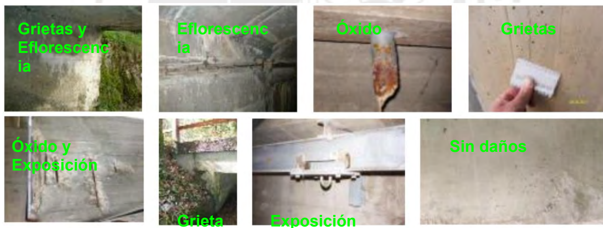
Figura 4. Daños comunes en puentes. De las patologías en puentes, en este proyecto, se analizan estos tipos de daños: Grietas, Eflorescencia, y Descascaramiento (Flotzinger, J., et al., 2023).
