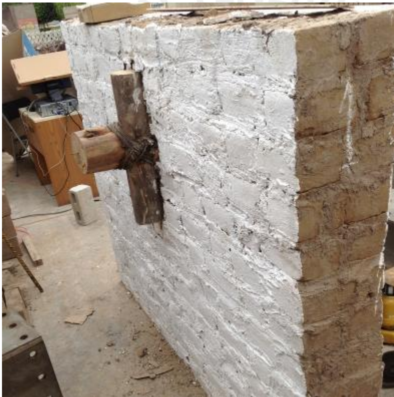
Fig.49 Refuerzo con Chavetas
