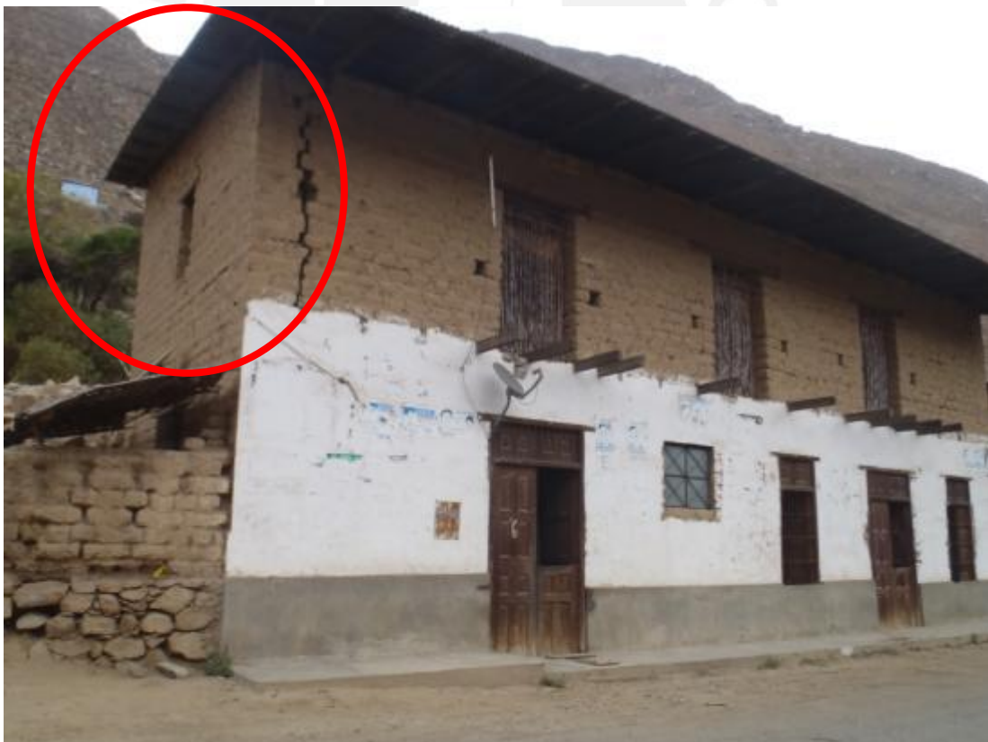
Fig.33 Muro en volado en peligro de caída inminente
