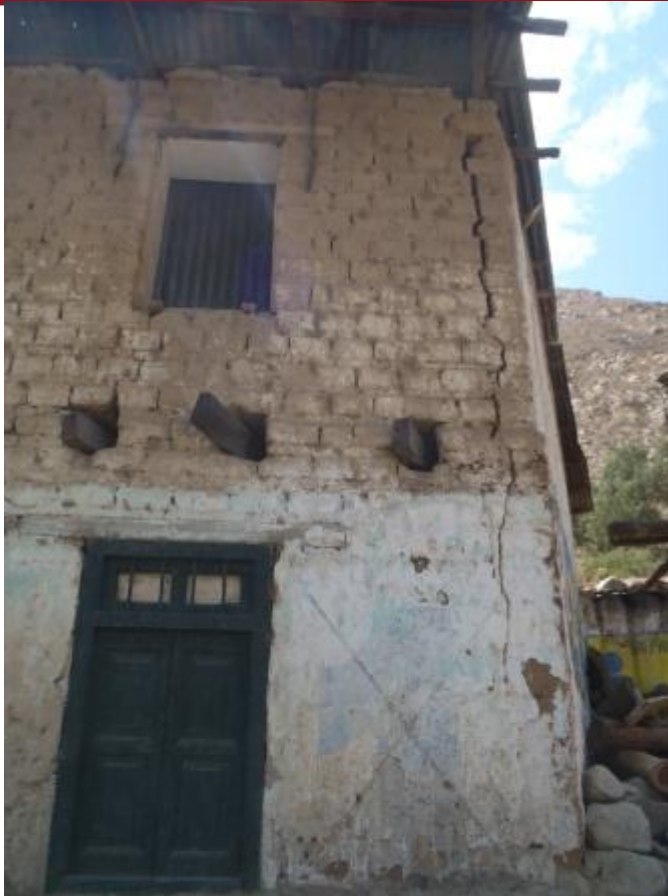
Fig.27 Grieta vertical en esquina superior de muro que baja hasta muro de primer nivel, Yaso
