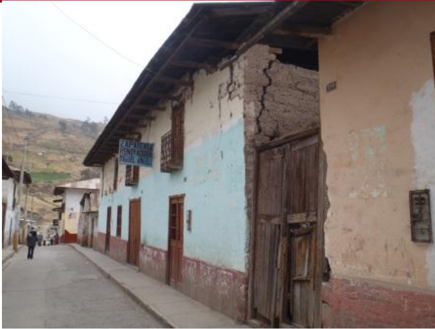
Fig.28 Grieta vertical en esquina superior de muro, Canta.
