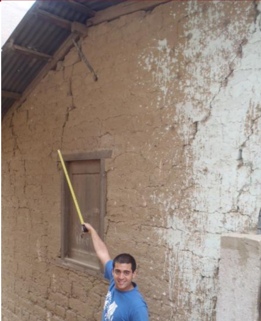
Fig.32 Grieta en la esquina de la venta por corte y concentración de esfuerzos
