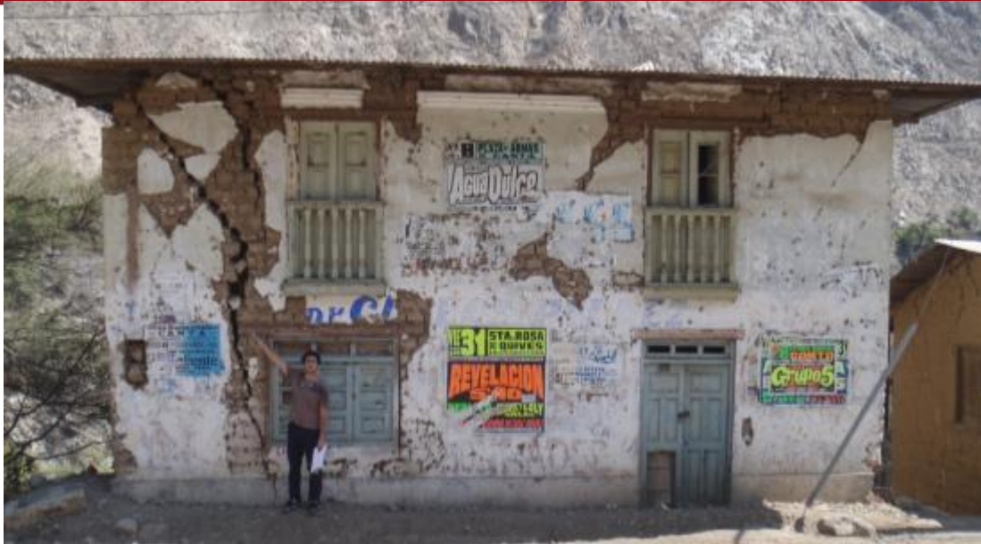
Fig.30 Grieta de Corte en el plano del Muro, Viguetas apoyadas en el muro impidiendo su volteo
