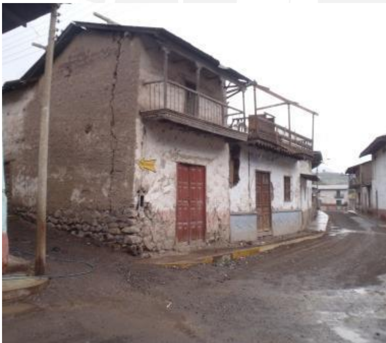
Fig.29 Grieta Vertical en toda la longitud del muro, Obrajillo
