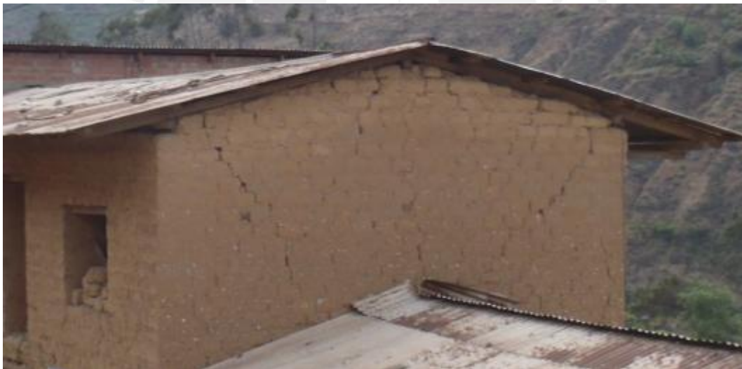
Fig.31 Grietas de corte en un muro sin vanos, con restricción al volteo por la cubierta.
