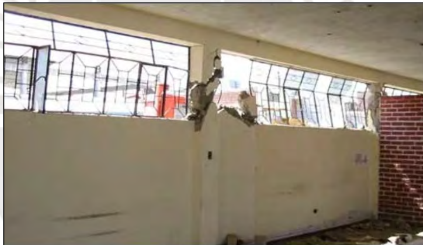
Figura 4: Efecto de Columna Corta. ( https://www.cuevadelcivil.com/2016/03/efecto-columna-corta-cautiva.html )
