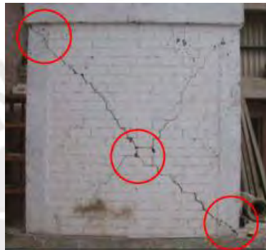
Figura 14. Muro después de ensayo de carga lateral cíclica (Fuente: Loayza y San Bartolomé)
