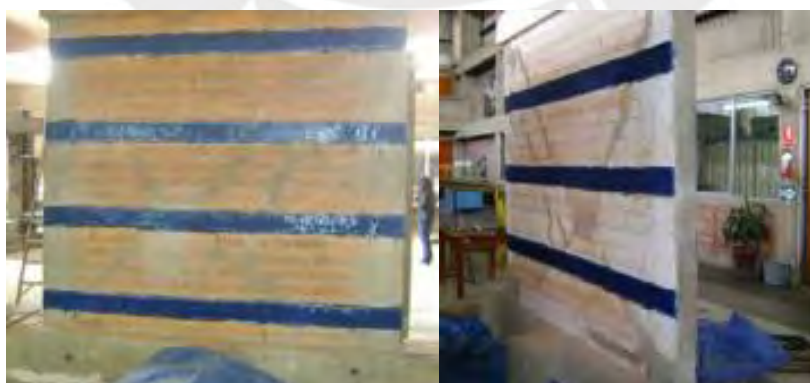
Figura 11. Aplicación de fibra de carbono sobre muro (Fuente: San Bartolomé y Coronel)
