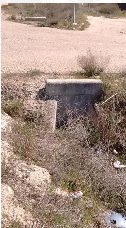
Paso salvacuneta tapado con vegetación
