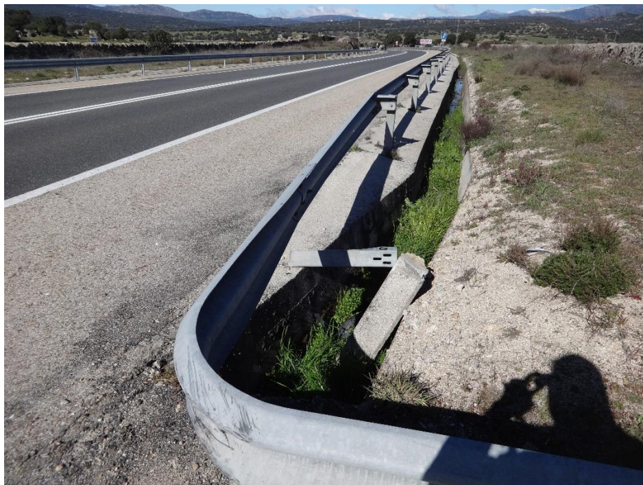
Barrera metálica dañada.
