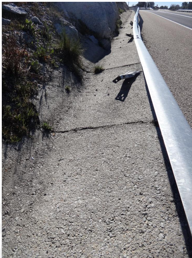
Barrera metálica averiada
