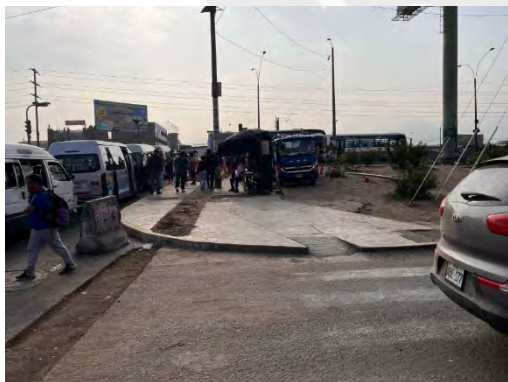
Foto 11: Cruceo peatonal desgastado y acera peatonal rota en la Av. Alfredo Mendiola.
