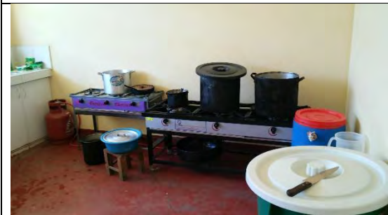
Utensios y equipos (cocina) en malas condiciones
