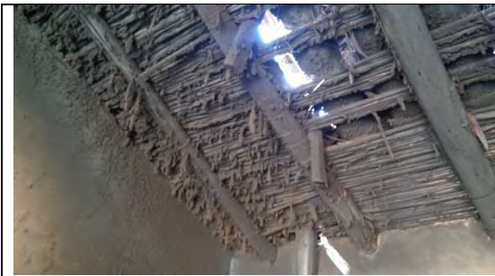
Techos de cocina en malas condiciones
