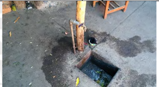
Malas condiciones de higiene, lavaderos no adecuados
