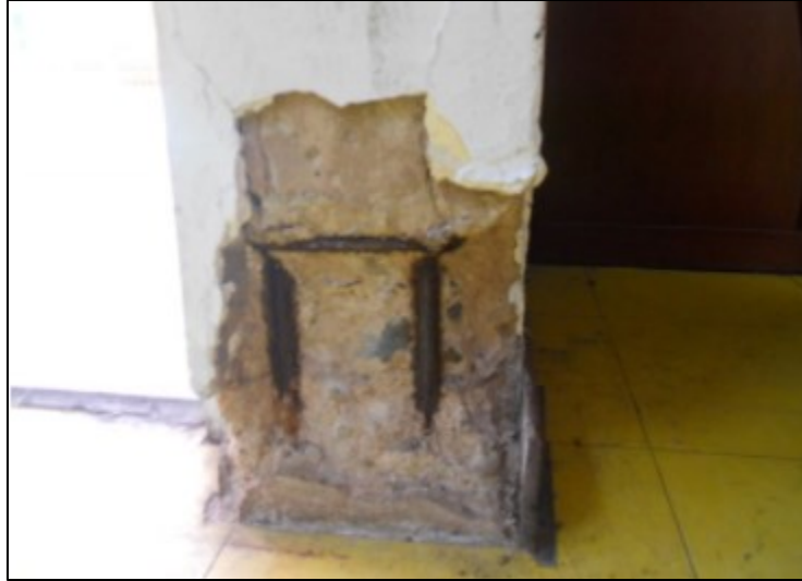
Figura 24: Corrosión de varillas de acero de refuerzo de columna de colegio limeño
