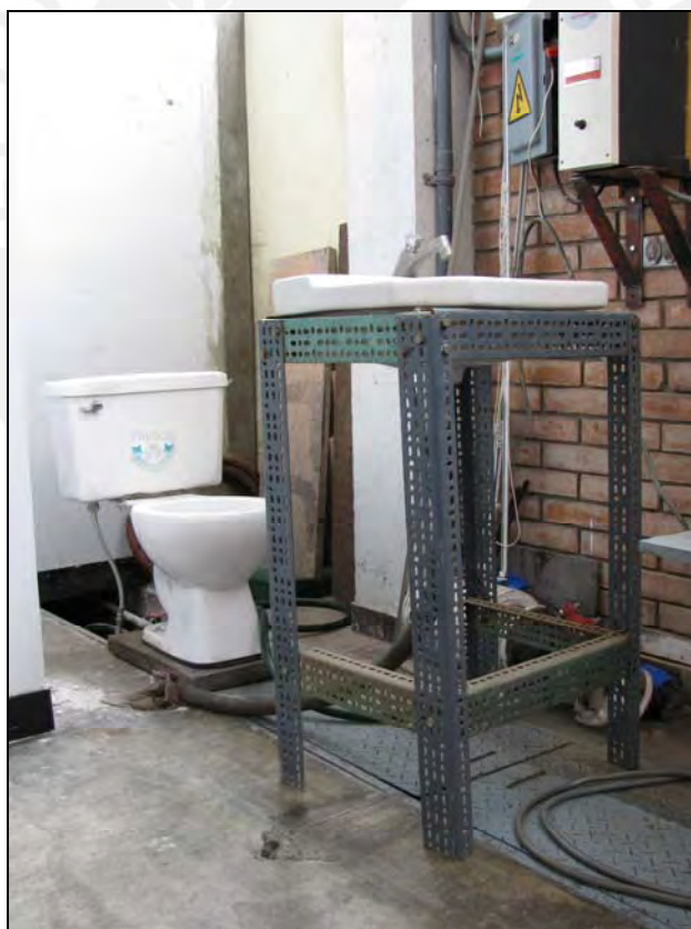
Fig. 2.2: Fotografía del Sistema Reutilización y Tratamiento de Aguas Domésticas Residuales para el accionamiento de Inodoros mediante un Sistema de Vacío.
