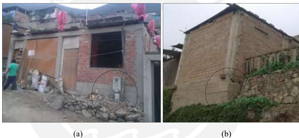
Figura 4.9 Fallas en las cimentaciones por (a) presencia de pircas y (b) cimentación expuesta (SENCICO, 2015)
