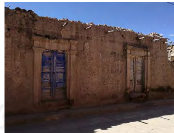
F. 20. Casona en deterioro Fotografía propia (2019)
