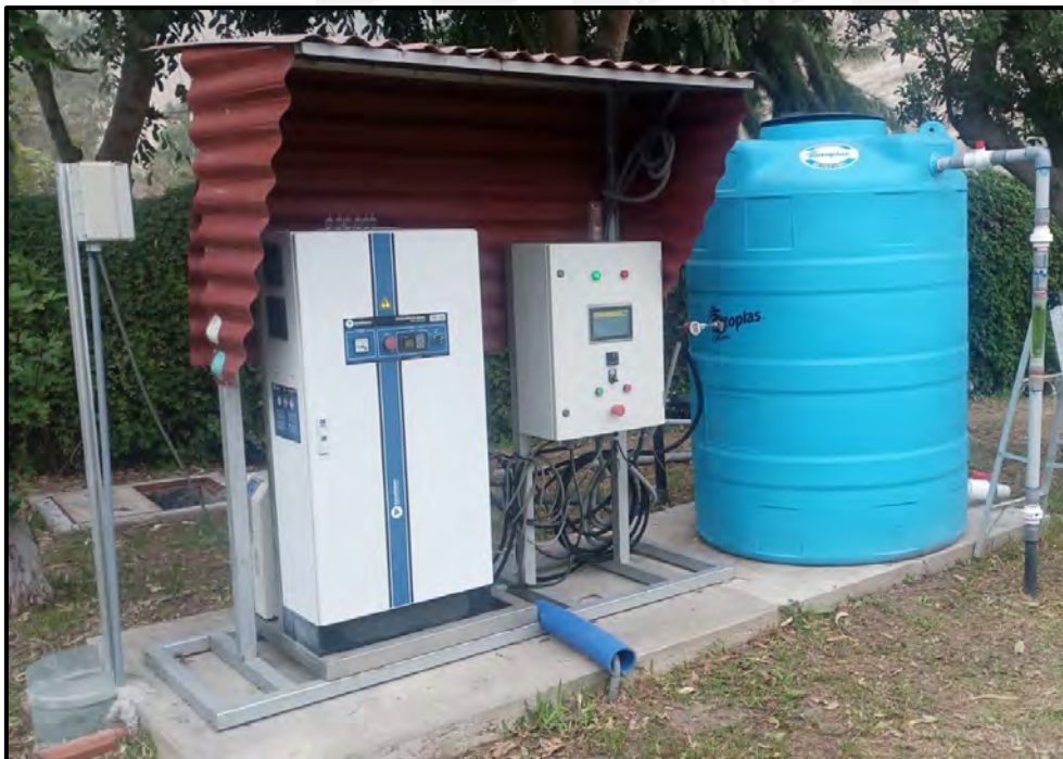
Figura 13. Fotografía tomada de las instalaciones de la planta de desinfección con ozono utilizada durante el proyecto de investigación.
