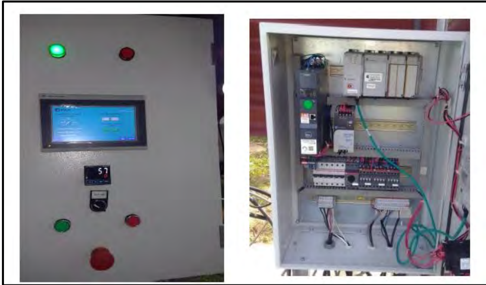
Figura 12. Fotografía tomada del Tablero de control de la planta de desinfección con ozono.
