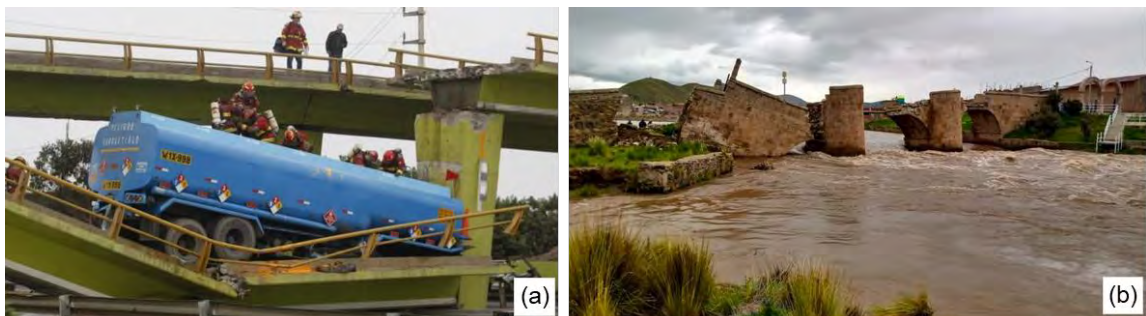
Figura 20. Puentes colapsados por factores de daño.
