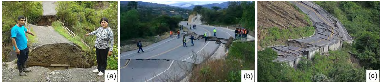
Figura 25. Colapso de infraestructura vial por sismos en el Perú
