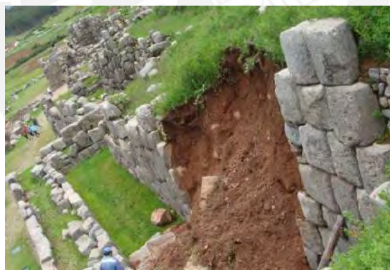
Figura 6-2: Sección colapsada de un muro en Sacsayhuamán
