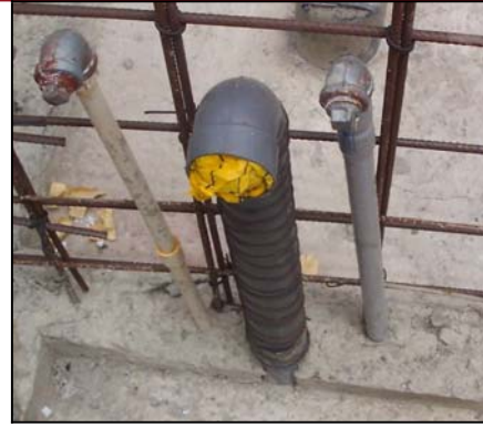
Figura 3.1.6: Falta de Recubrimiento
