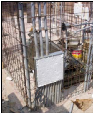
Figura 3.1.3: Congestión de Tuberías
