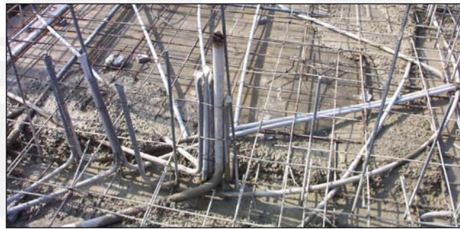
Foto 2.3.63: Distribución de Tuberías
