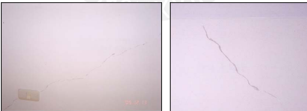
Foto 2.3.55 y 2.3.56: Fisuras en Muros
