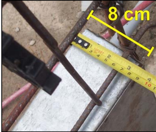
Foto 2.3.39: Falta de Recubrimiento y Detalle de Caja Eléctrica
