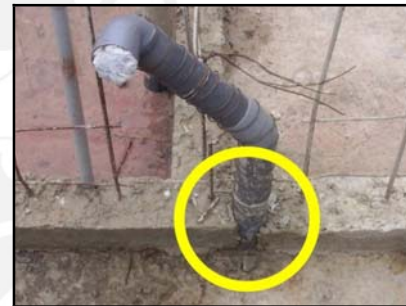
Foto 2.3.41: Falta de Recubrimiento
