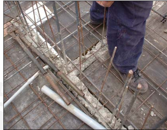
Foto 2.4.26: Base de Muro sin Tratar en la Losa.
