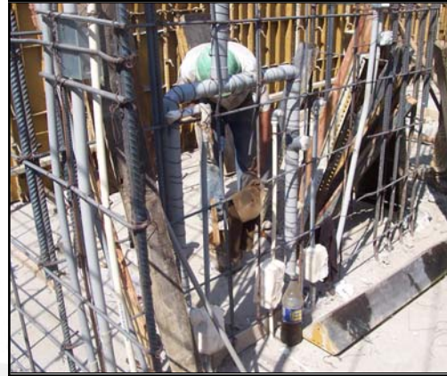
Foto 2.3.40: Congestión de Tuberías y Refuerzo
