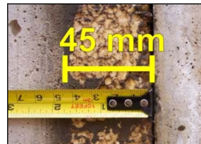
Foto 3.1.1: Separación entre Bloques
