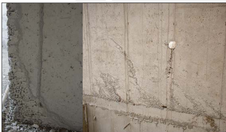
Foto 2.4.23: Segregación en Esquinas y Bases de Muros
