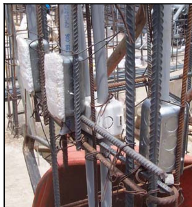
Foto 2.3.37: Congestión de Tuberías
