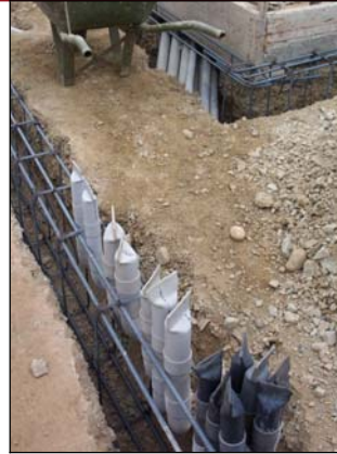
Foto 2.3.19: Congestión de Tuberías
