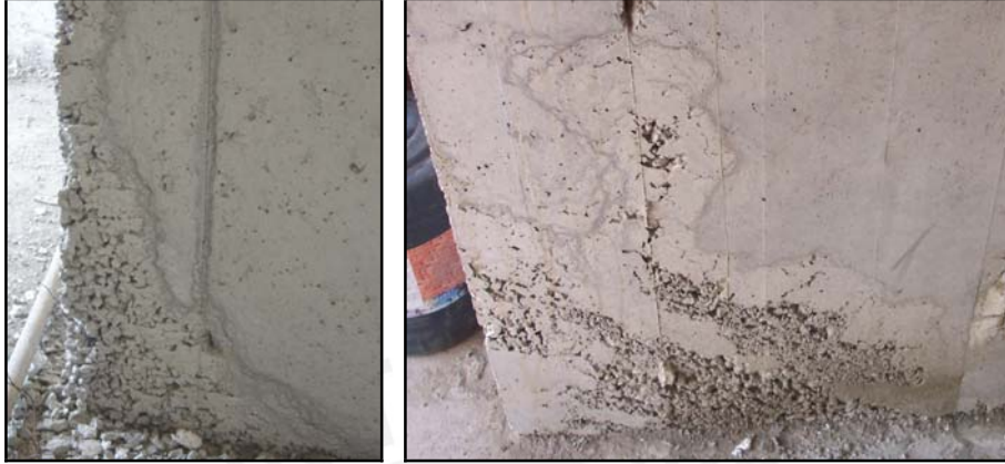
Foto 2.3.51 y 2.3.52: Segregación en la Base de Muros
