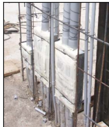
Foto 2.3.38: Congestión de Tuberías y Cajas.
