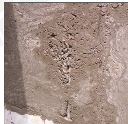
Foto 2.4.24: Cangrejeras por Tuberías.
