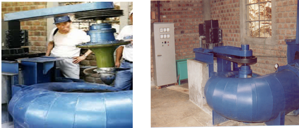
Figura 1.6: Turbina semi Kaplan instalada en Jaén, Cajamarca.
