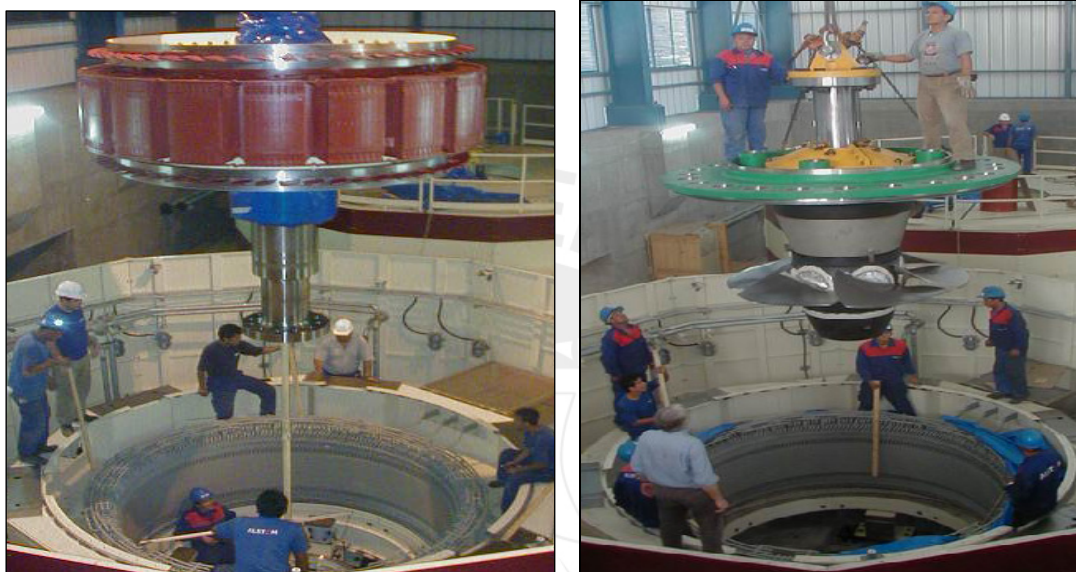
Figura 1.5: Generador síncrono y turbina Kaplan, central hidroeléctrica de Pochos 1.
