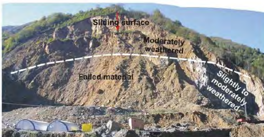
Figura 7-6: Vista general del talud Cayeli - Katampasa (Dinc et al. , 2011)
