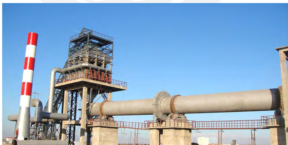
Figura 3.1. Horno rotatorio de una fábrica de cemento.
