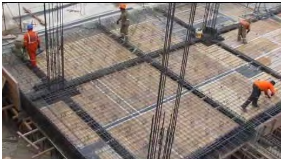
Figura 8: Acero de refuerzo colocado previo al vaciado de la losa maciza bidireccional
