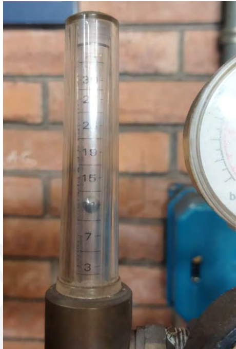
Figura 55. Verificación del caudal de gas argón.
