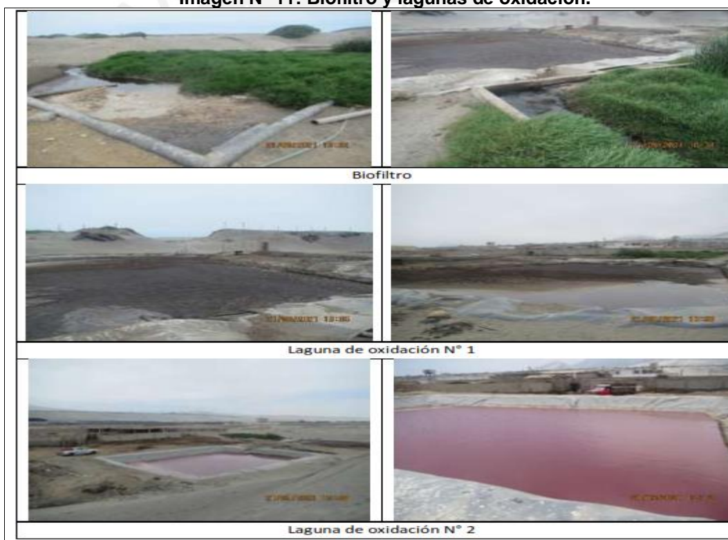
Imagen N° 11: Biofiltro y lagunas de oxidación.
