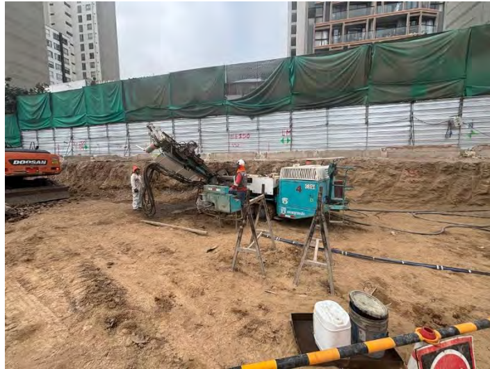
Figura 1. Maquina perforadora de anclajes realizando los orificios del primer anillo. Nota. Tomado de Inmobiliaria 2.
