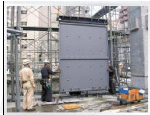
Figura 11: Muro Disipadores WVD (Wall Viscous Damper)
