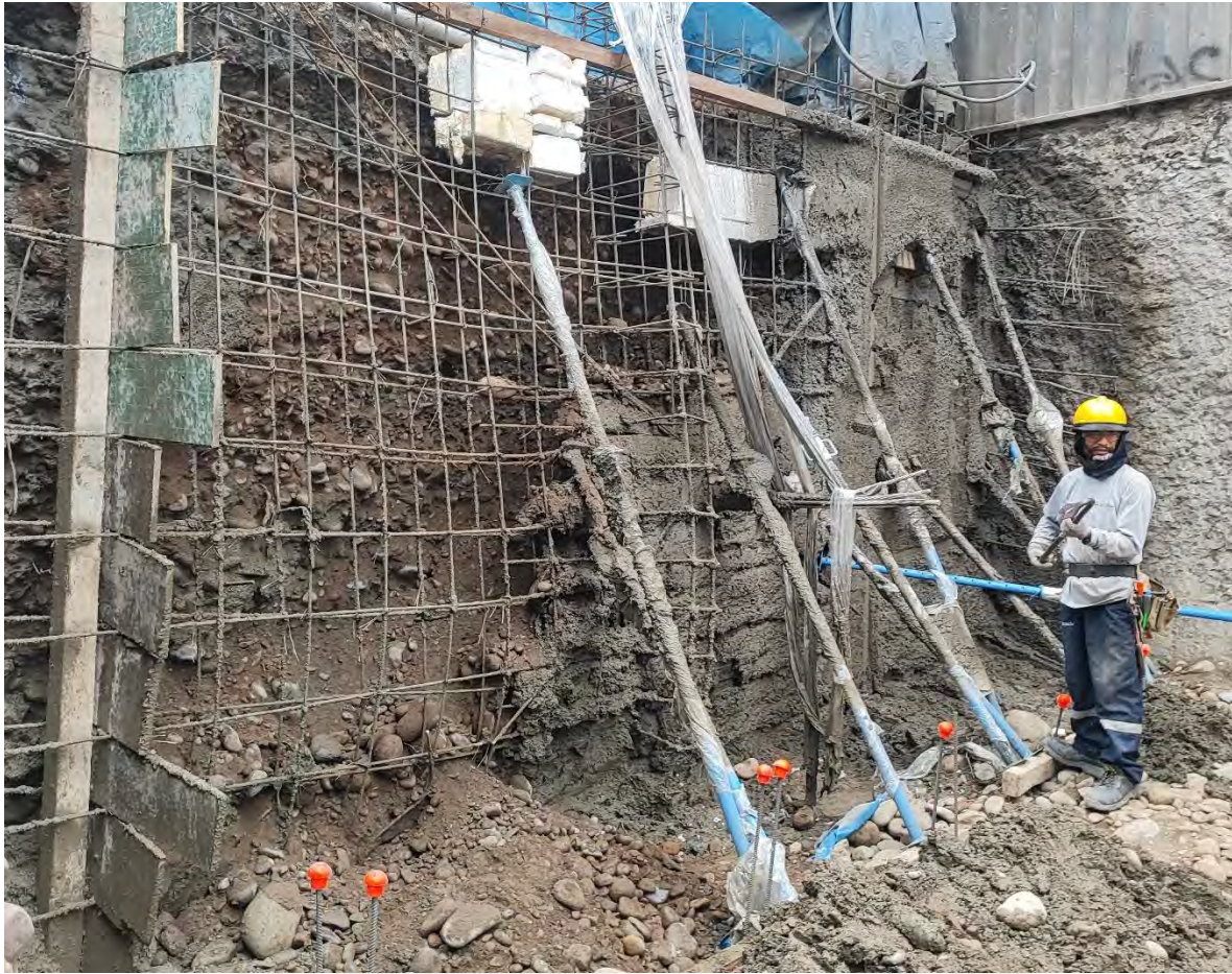
Figura 31. Desprendimiento del concreto por inestabilidad del concreto en el primer anillo.
