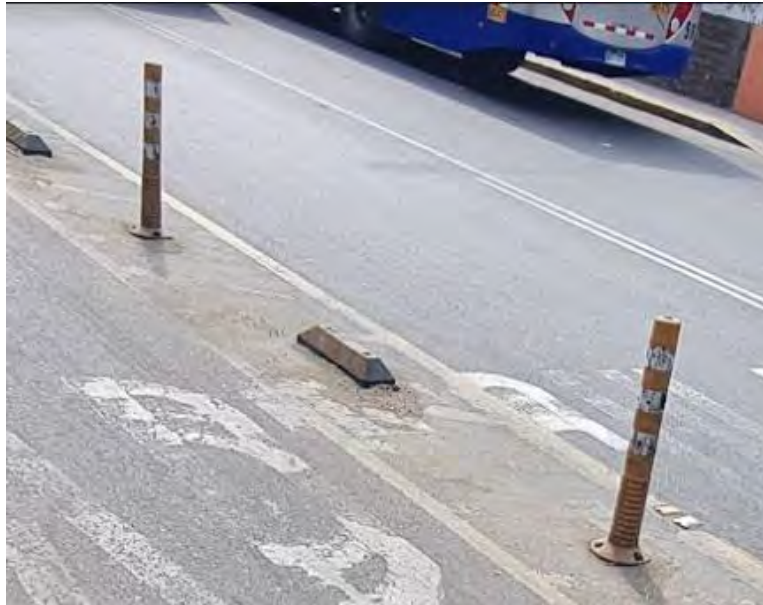
Figura 32 Bolardos desgastados ubicados entre las intersecciones con Av. Guardia Republicana y Av. Francisco Pizarro.
