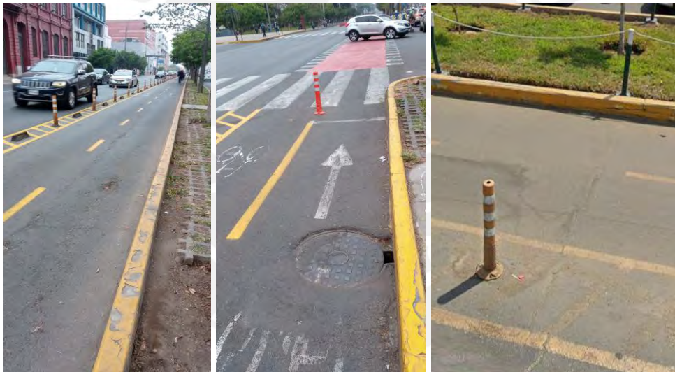
Figura 25 Imperfecciones en la superficie de rodadura, de izquierda a derecha bache en carril, desnivel por tapa de servicio y fisura transversal de severidad baja
