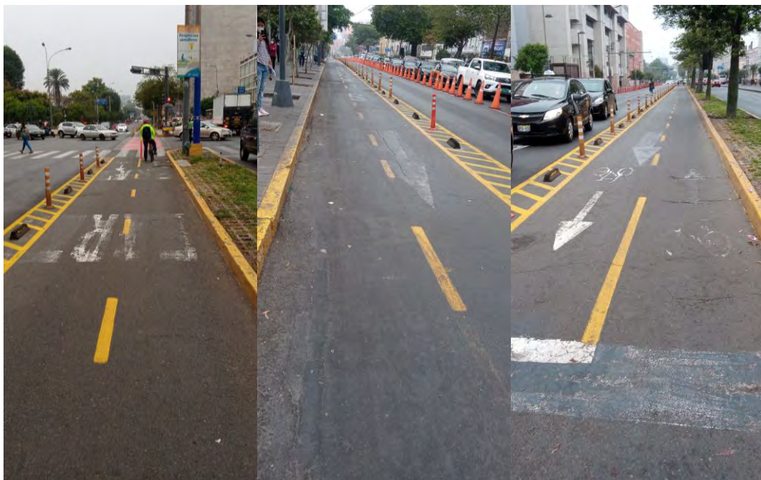
Figura 31 Señales horizontales de pare y flechas de dirección de flujo de tránsito despintadas. De izquierda a derecha las intersecciones son: Av. España, Av. 9 de Diciembre y Av. 28 de Julio.
