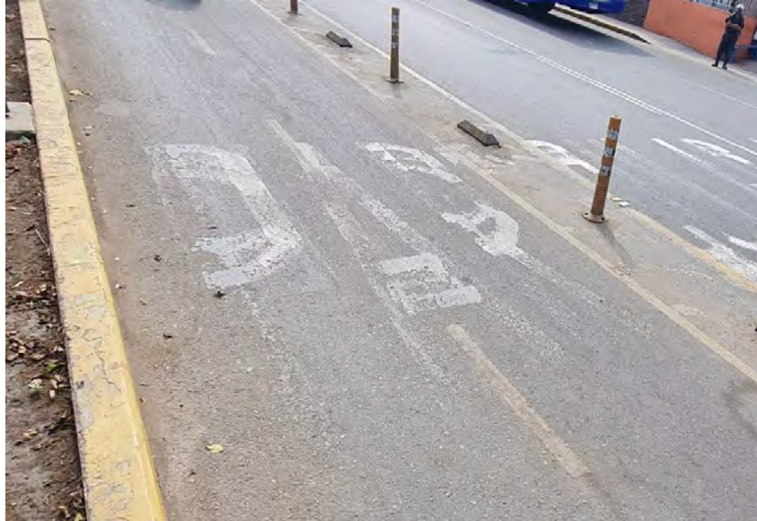
Figura 30 Señal horizontal de pare despintada entre las intersecciones Av. 28 de Julio y Jr. Manuel Copancho.
