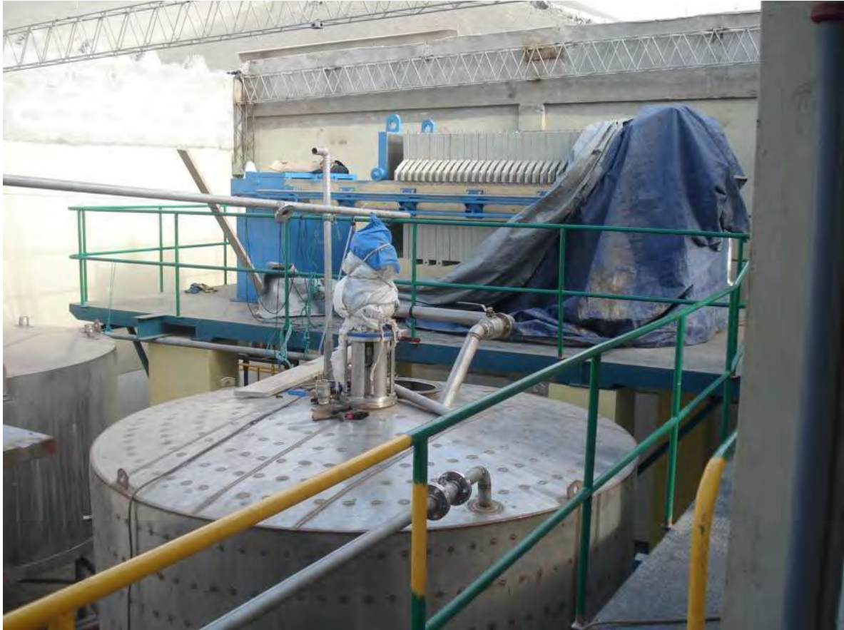
Figura M.1 Montaje de filtro prensa
