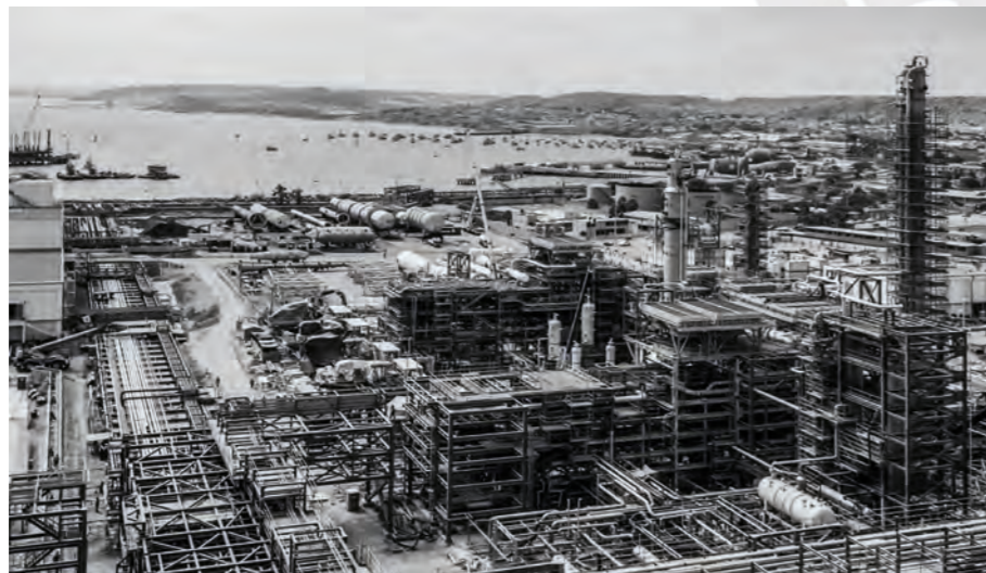
Fig. 34. Infraestructura energética (Piura). Refinería de Talara el borde costero. Fuente: Agencia Andina (2023).
