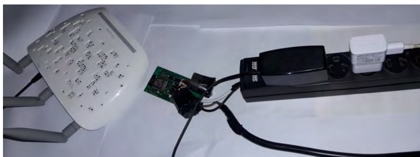
Fig. 4.3: Conexión inalámbrica del medidor con el Wi-Fi del domicilio Fuente propia
