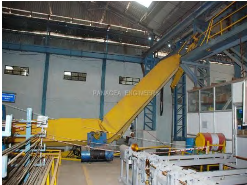
Figura 1.1 Falla estructural de una grúa puente debido a colapso viga principal. Tomado de: (Panacea Engineers. 2025).
