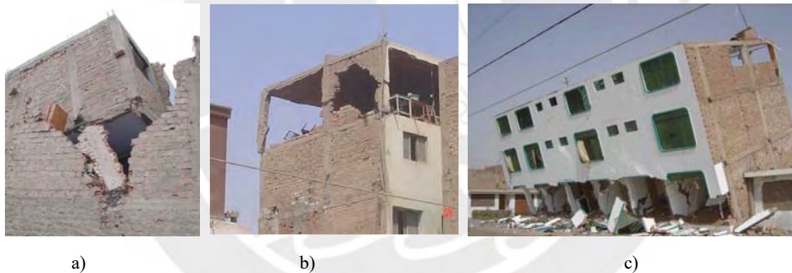
Figura 2.6 - Fallas en edificios con albañilería confinada Terremoto en Perú, Pisco (2007), a) Uso de material inadecuado: ladrillo Pandereta, b) Volcamiento por mal proceso constructivo: junta al ras de muros con columnas y c) Mala estructuración y distribución de arquitectura: Piso Blando y Torsión [10].
