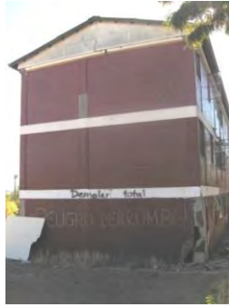
Figura 2.11 - Falla a flexión terremoto en Chile, Cauquenes 2010 [11].
