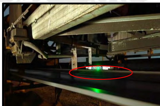
Figura 5.1: Robot móvil monitoreando entre el lado de carga y retorno de la faja transportadora de mineral 014003
