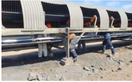
Figura 4.7: Instalación de La Pista Del Robot Móvil– rieles 8800 metros, entre el lado carga y el retorno.
