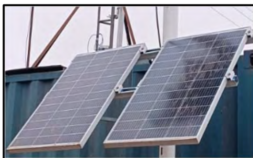
Figura 4.12: Panel Solar Instalado en la faja Transportadora de Mineral 014003
