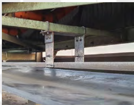
Figura 4.8: Cierre de la instalación de rieles para 4 Robots Móviles de inspección El kilometraje total de inspección para cada robot móvil es de 2200 metros.
