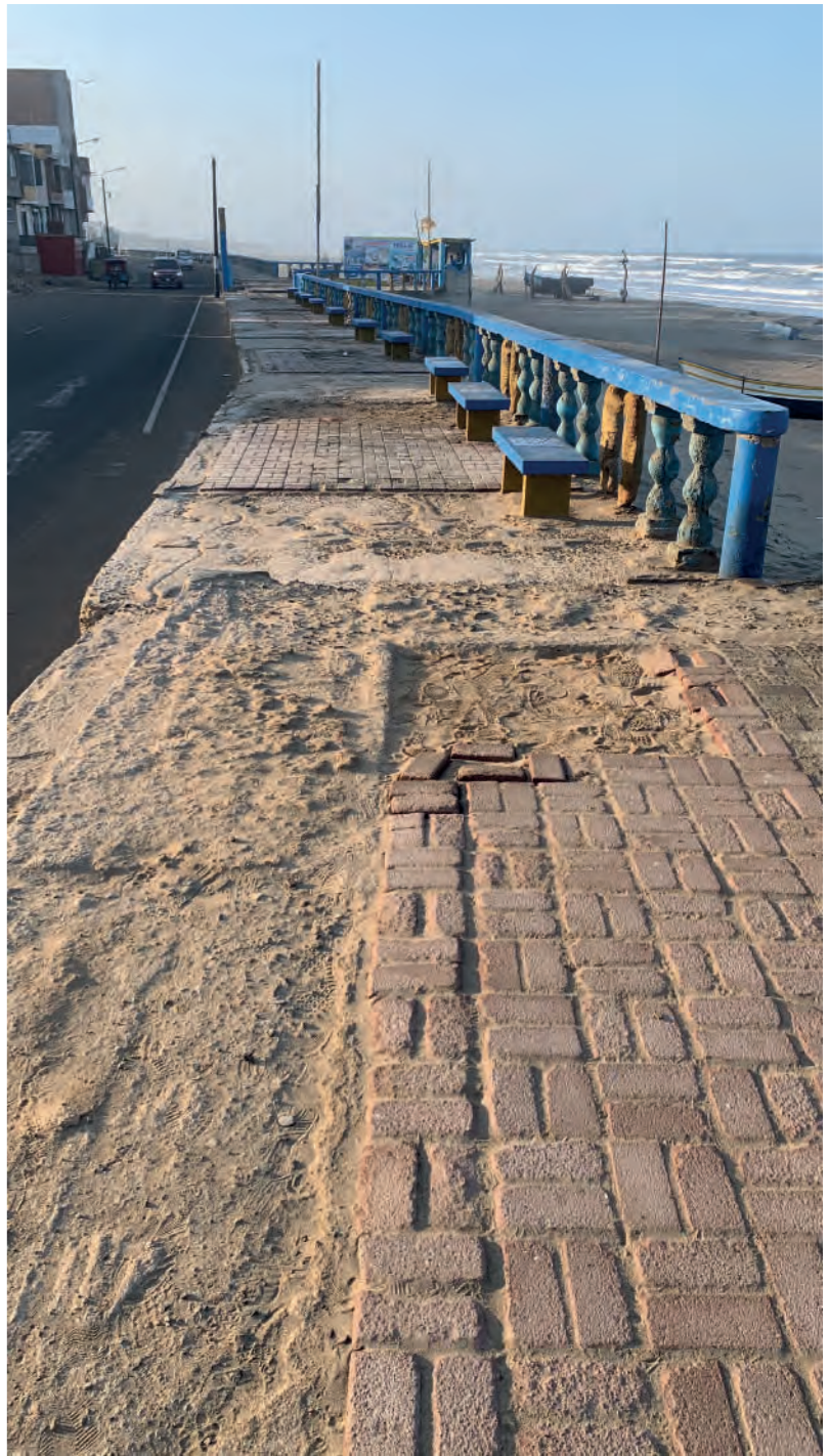
Asfalto de malecón en estado precario. Fuente: Fotografía propia 2024.
