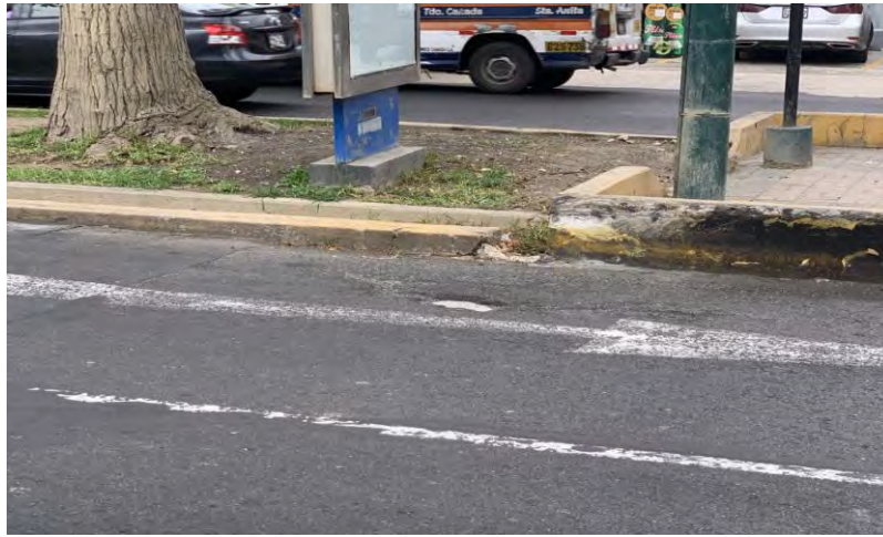
Figura 19: Deterioro encontrado en la calzada con partículas desprendidas
