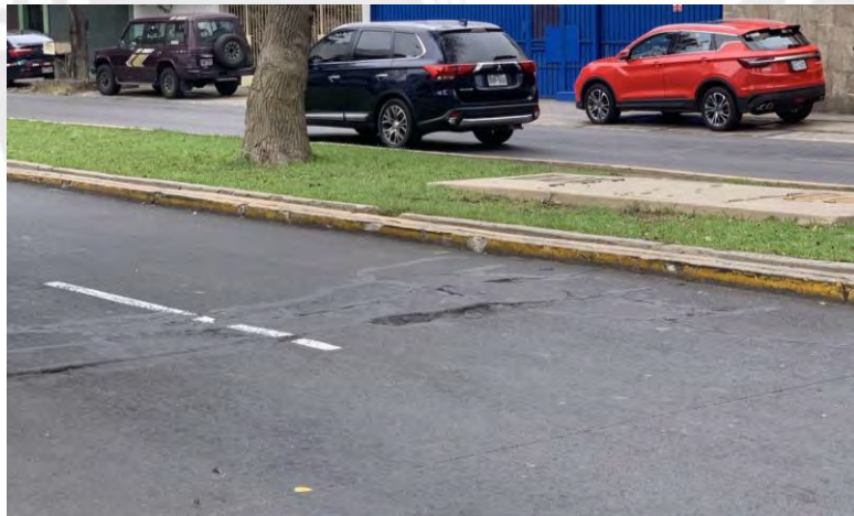
Figura 18: Deterioro encontrado en la calzada
