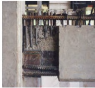
Figura 20. Conexión soldada en el lecho inferior.
