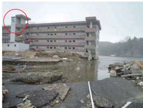
Figura 5. Estado de edificio en las partes altas post-tsunami. (JICA, 2011)
