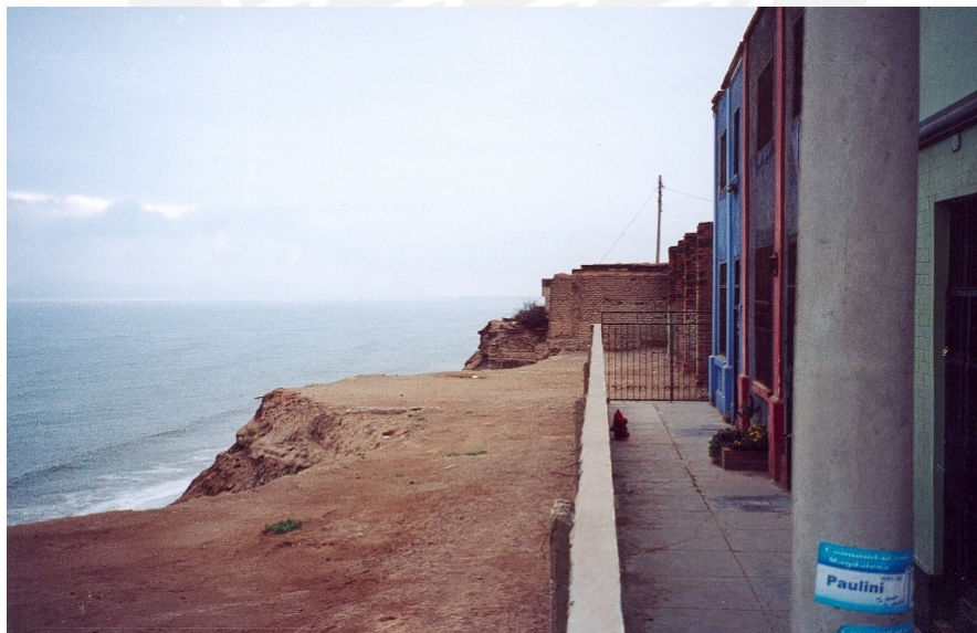
Cerco perimétrico, en el cual la corona del talud casi ha alcanzado a las casas. La distancia de la corona al muro es de 4m. Noviembre 2002
