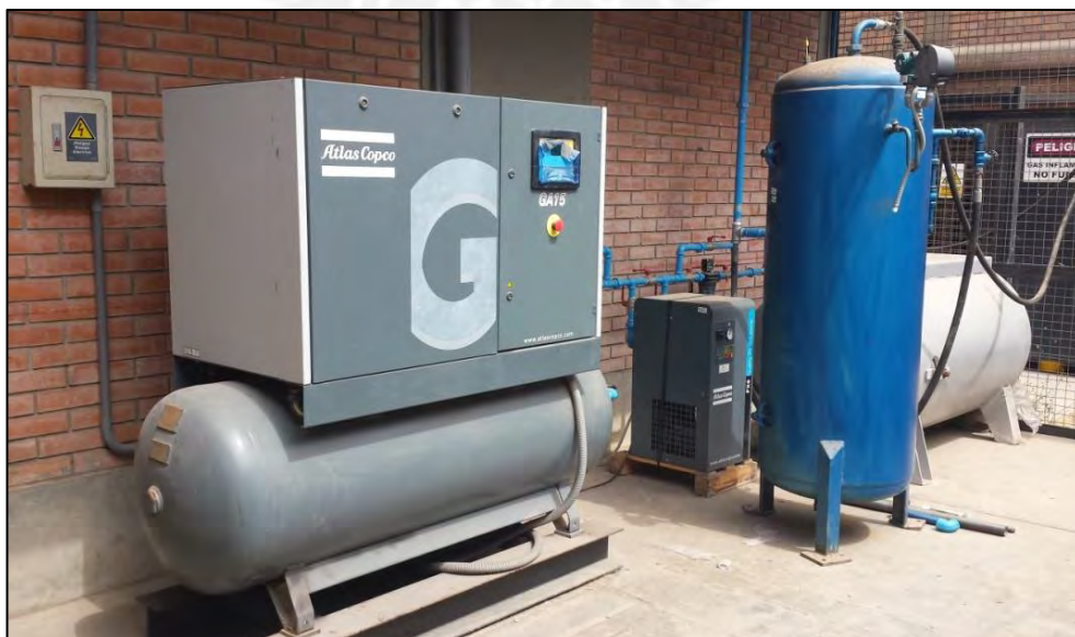
Fig. 2.1: Estación de compresión
