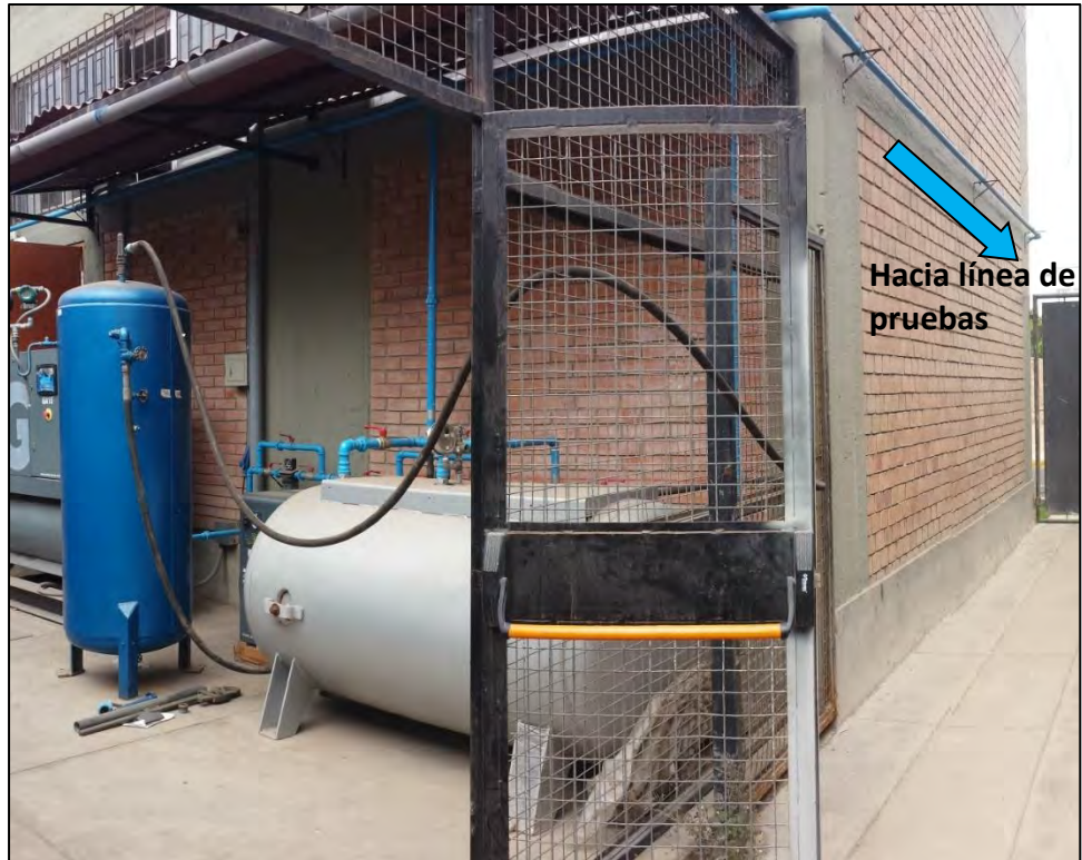
Fig. 2.9: Tanques y sistema de tuberías
