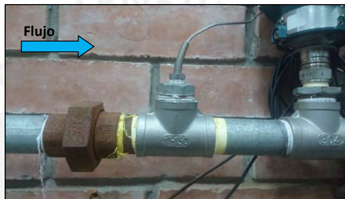
Fig. 2.16: Sensor de temperatura instalado.
