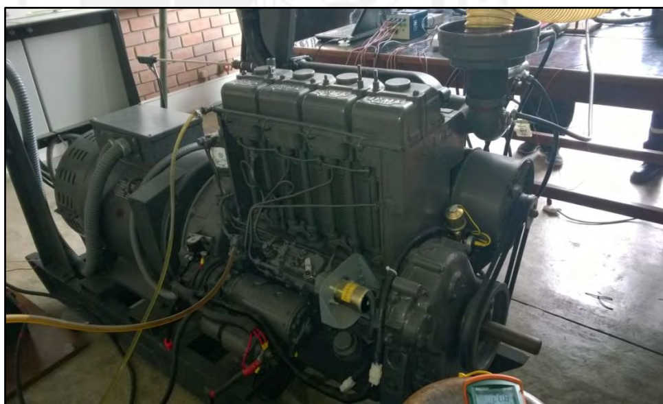
Figura 3.2. Grupo electrógeno: motor Lister HR4 y generador Frapil 45kVA.
