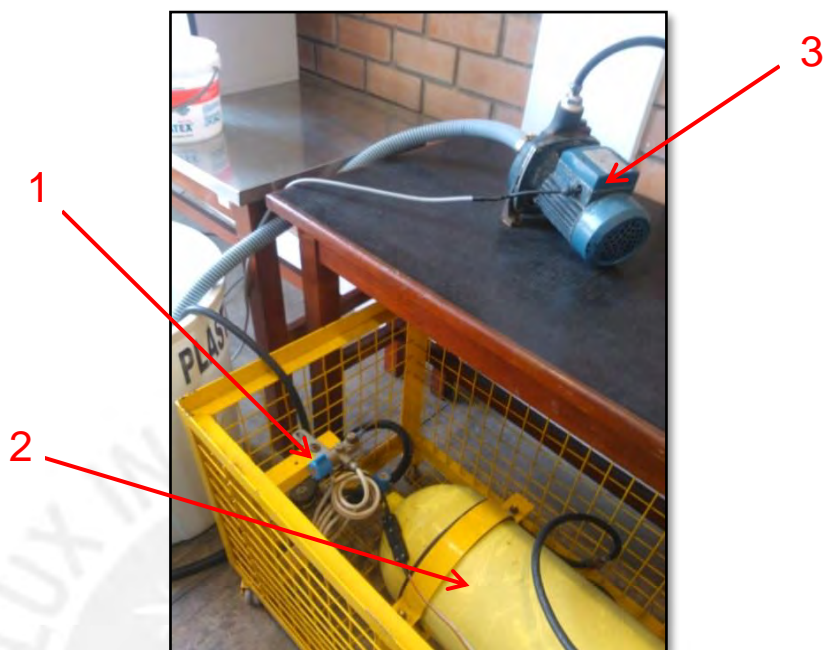
Figura 3.9 - Equipos para suministrar gas natural.
