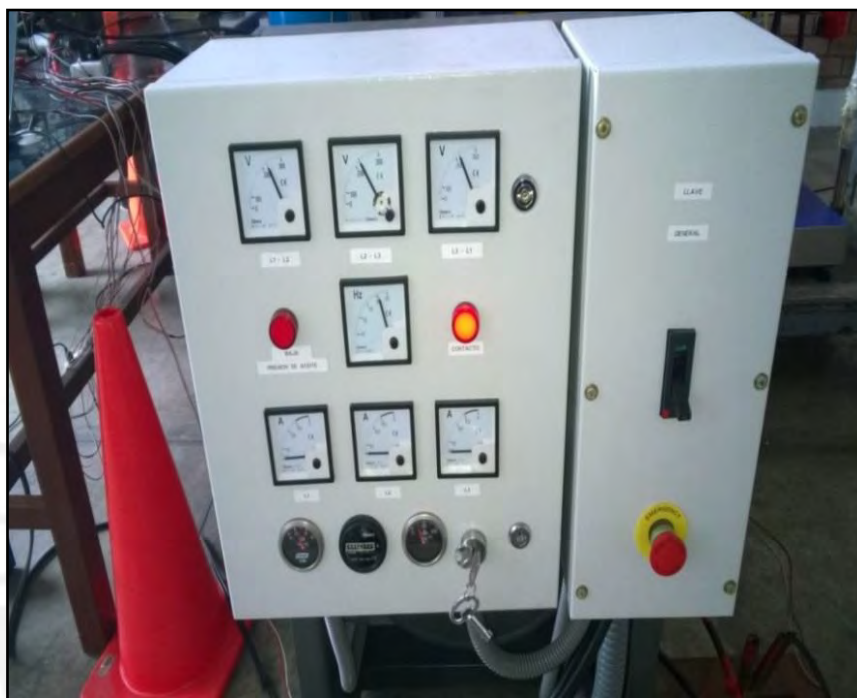
Figura 3.11 - Tablero de control del grupo electrógeno.
