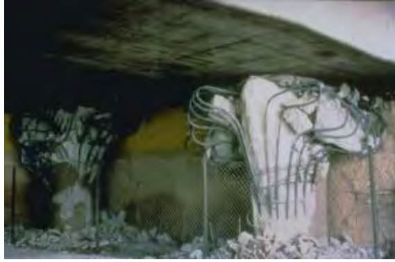
Figura 2.16 Falla por estribos insuficientes en el sismo de Northridge (www.ngdc.noaa.gov)
