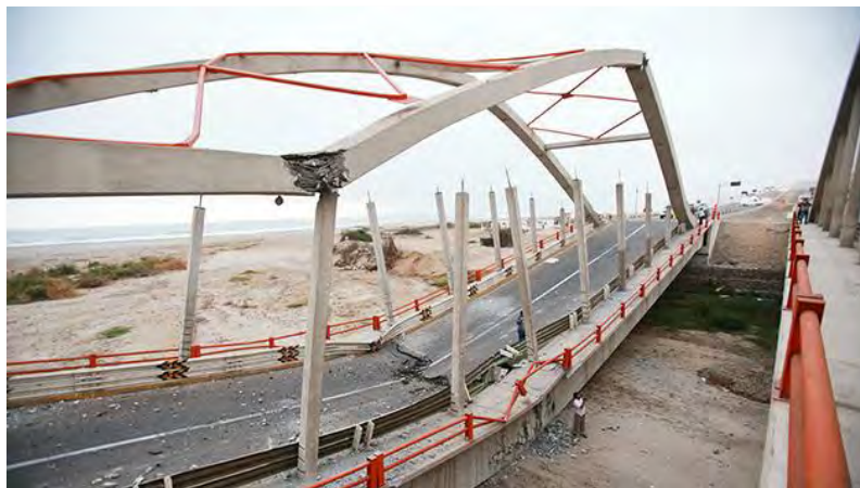
Figura 2.7 Falla en puente Topara entre Chincha y Cañete ( www.ecoshuacho.pe )
