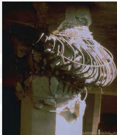
Figura 2.15 Falla por aplastamiento en el sismo de Northridge ( www.ngdc.noaa.gov )
