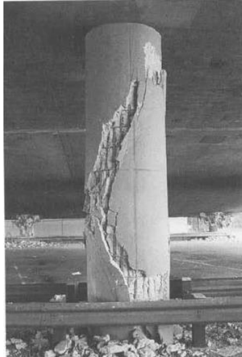
Figura 2.14 Falla por cortante en el sismo de Northridge [6]
