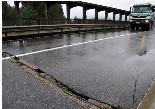
Figura 2.5 Un camión se aproxima a la junta de dilatación en mal estado ( www.farodevigo.es )
