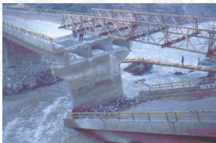
Figura 2.8 Falla de un puente en Huachipa [5].
