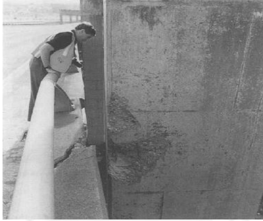
Figura 2.12 Falla por golpeteo en el sismo de Loma Prieta [6]
