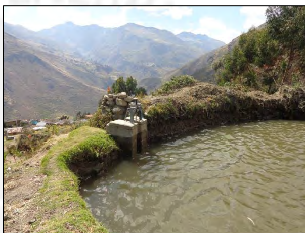
Bocatoma de salida del reservorio Shicacocha.
