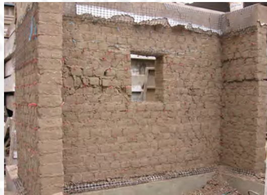
Figura 4.18 Muro con geomalla después de retirar el tarrajeo (después del ensayo).
